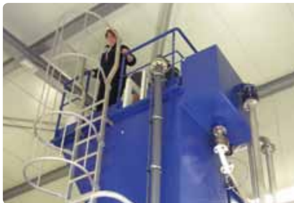
Proefinstallatie voor verwijdering van organisch materiaal in Kluizen
